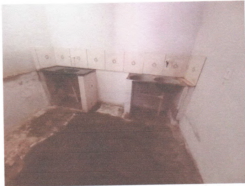
Figura 15 – Instalações hidrossanitárias: área de serviço
