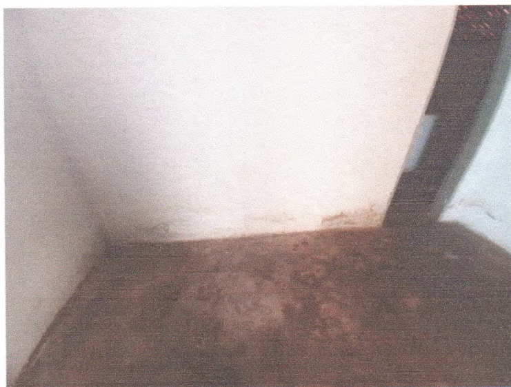
Figura 5 – Infiltração por capilaridade
