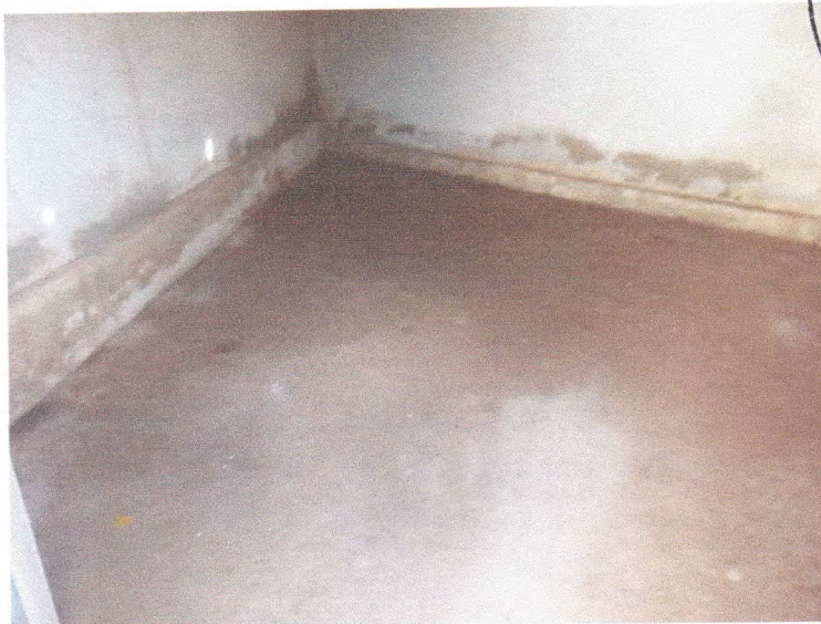
Figura 4 – Absorção de água pela viga baldrame
