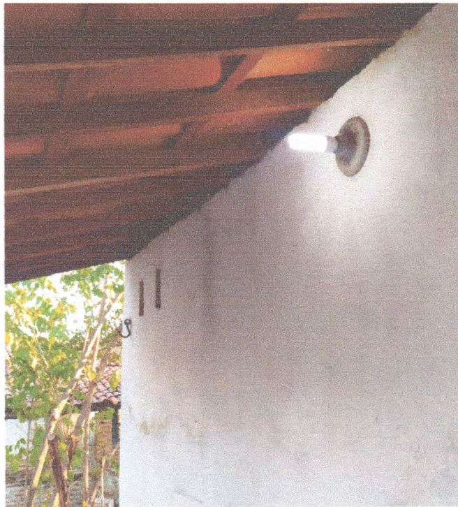
Figura 14 – Ponto iluminação da área de serviço
