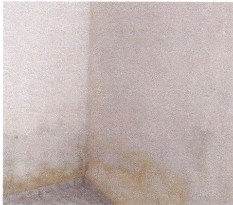
Figura 4 – Paredes e teto com manchas de umidade
