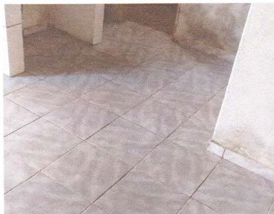
Figura 10 – Piso cerâmico da cozinha
