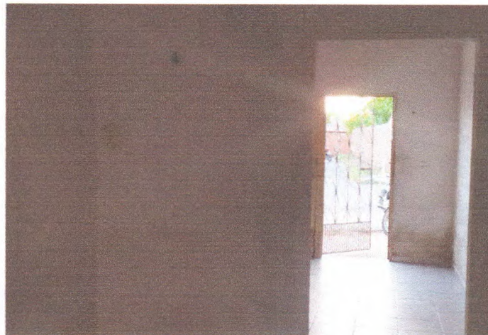
Figura 7 – Parede com pintura manchada
