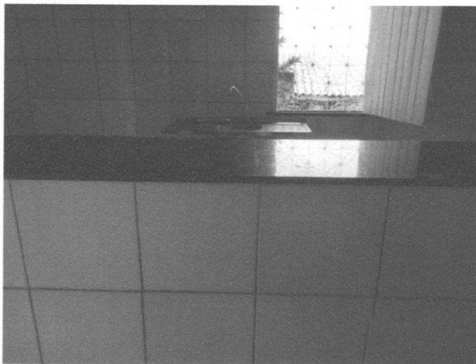
Figura 13 – Instalações hidrossanitárias: cozinha
