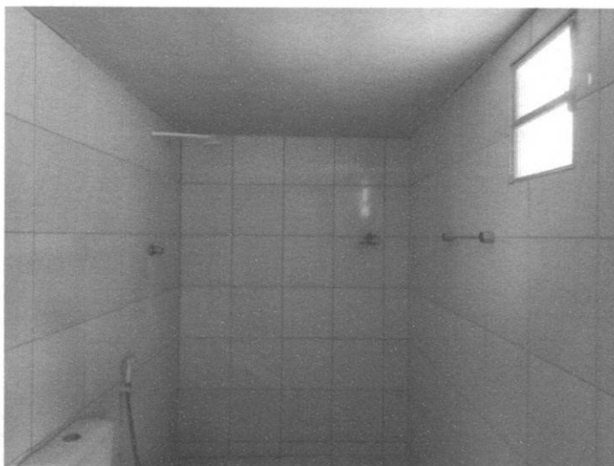
Figura 12 – Instalações hidrossanitárias: banheiro
