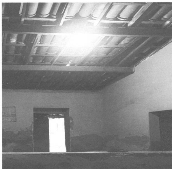
Figura 12 – Ponto de iluminação
