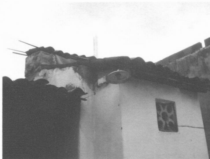
Figura 6 – Caixa d'água em deterioração
