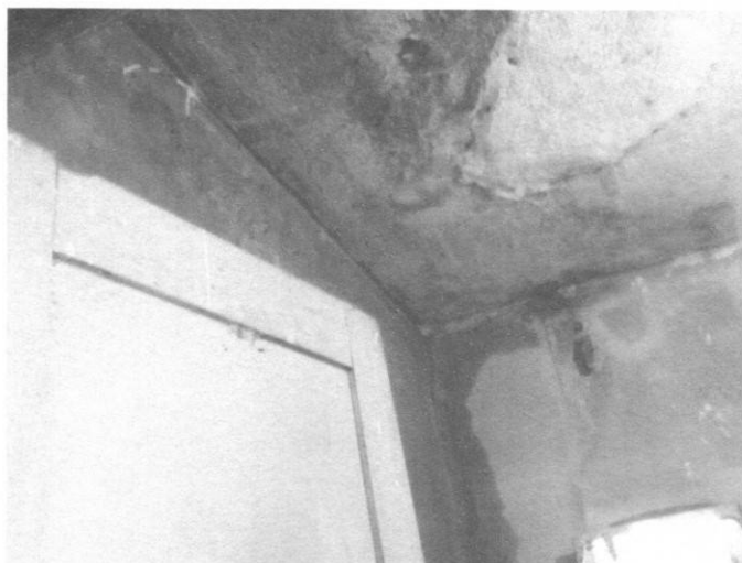
Figura 5 – Umidade na laje do banheiro
