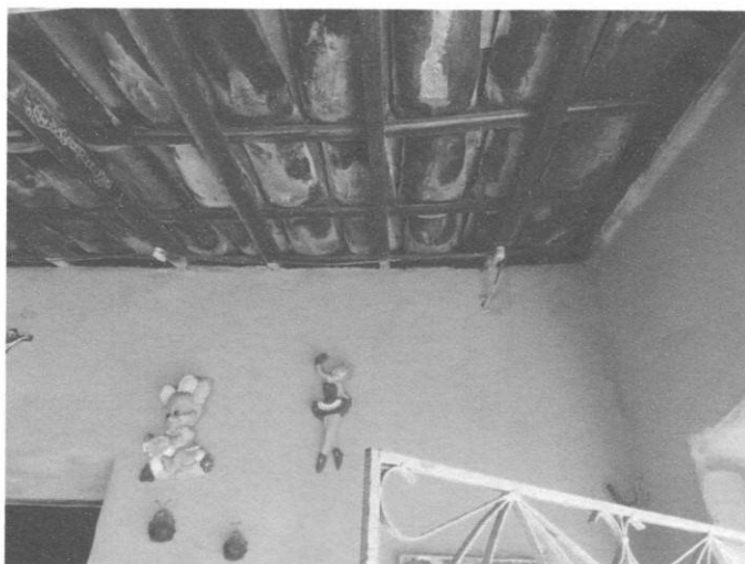
Figura 3 – Caibros e ripas apoiados na parede
