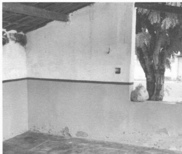
Figura 6 – Revestimento da parede externa desagregado
