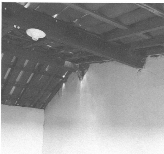
Figura 13 – Instalação de ponto de iluminação em desacordo com as normas técnicas
