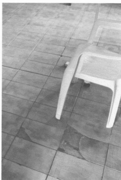
Figura 8 – Fissura no piso na sala de recepção
