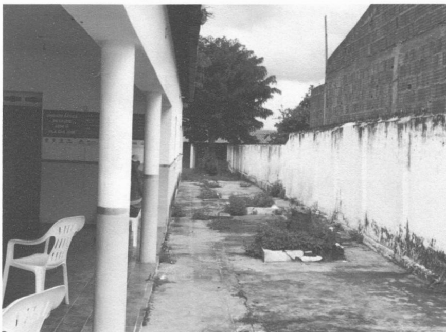
Figura 15 – Telhado sem calha
