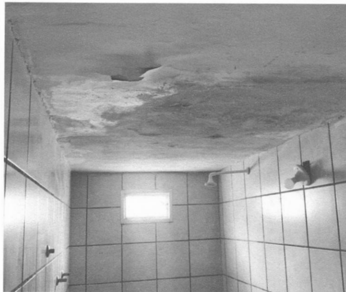
Figura 3 – Destacamento da pintura da laje do banheiro do consultório
