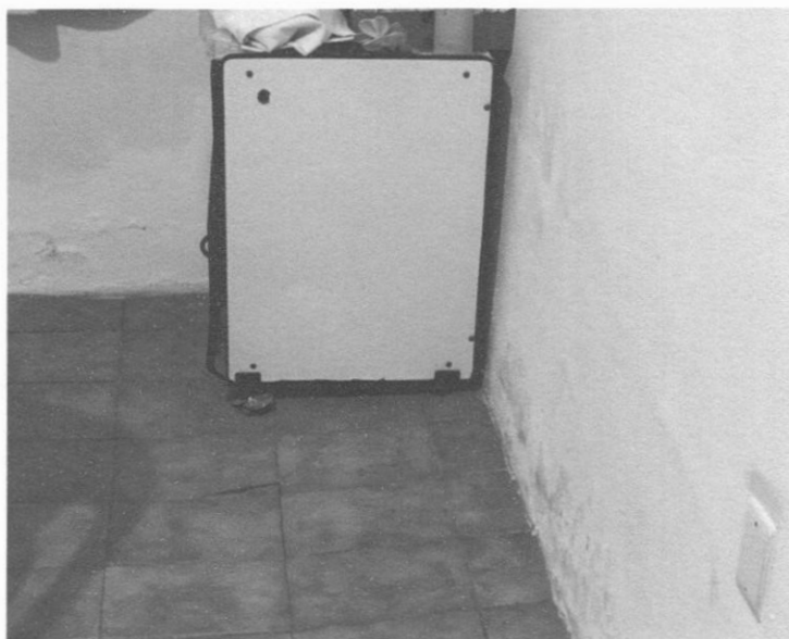
Figura 7 – Fissura no piso do consultório
