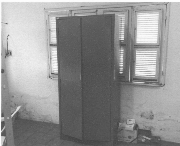
Figura 9 – Bolor na parede da sala de medicamentos
