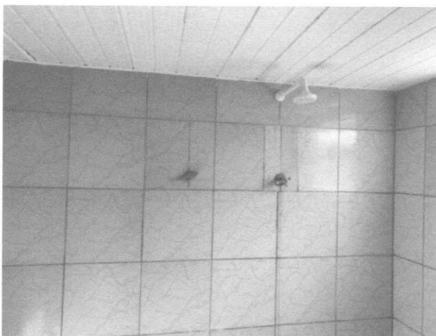
Figura 11 – Instalações hidrossanitárias banheiro
