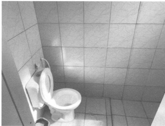
Figura 12 - Instalações hidrossanitárias banheiro
