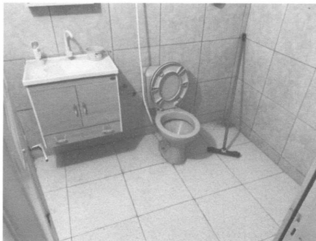
Figura 13 – Instalações hidrossanitárias banheiro
