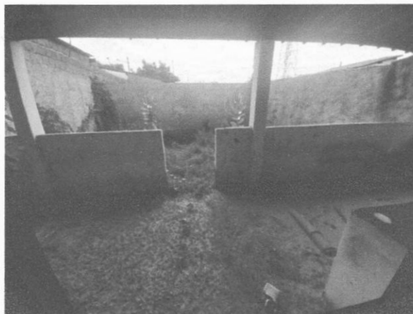
Figura 6 – Infiltração por capilaridade
