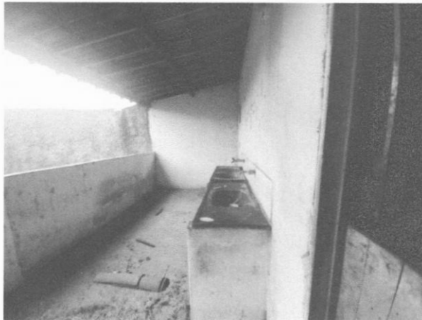
Figura 15 – Instalações hidrossanitárias lavanderia
