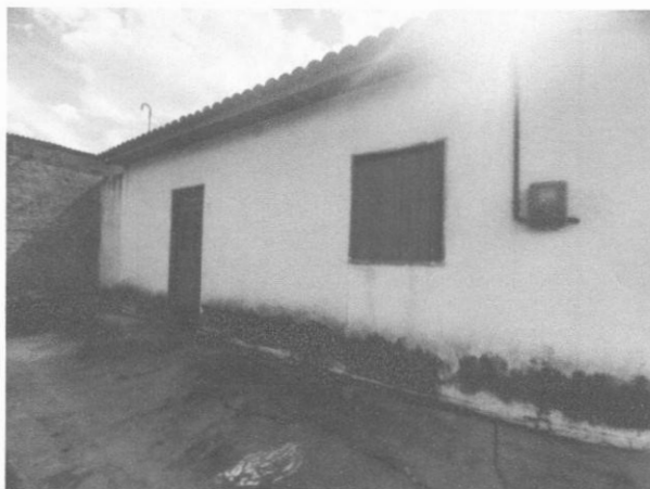
Figura 5- Infiltração por capilaridade
