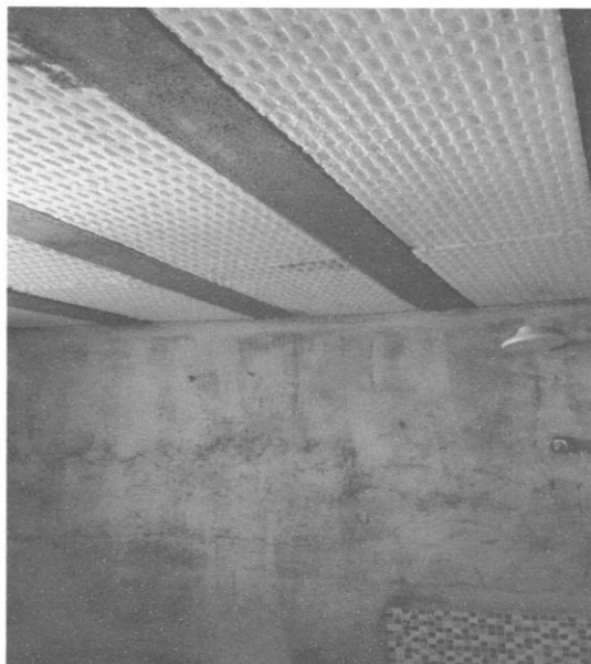
Figura 3 – Estrutura da laje do banheiro não finalizada
