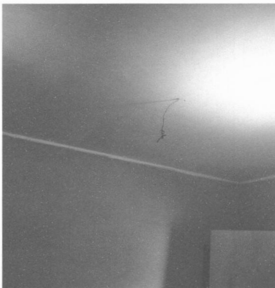
Figura 7 – Ponto de iluminação
