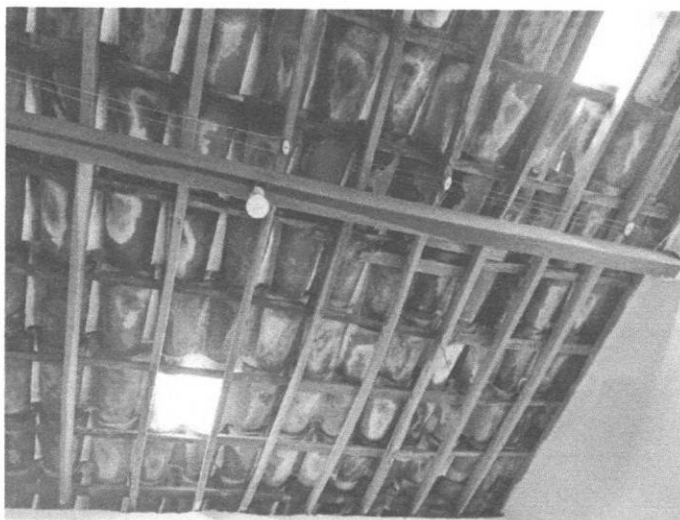
Figura 7 – Ponto de iluminação no telhado
