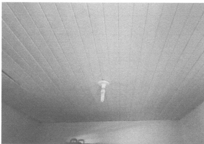
Figura 6 – Luminária no forro PVC
