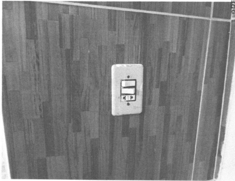
Figura 8 – Ponto de energia
