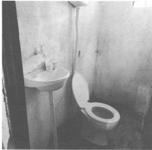
Figura 14 – Instalações hidrossanitárias: banheiro
