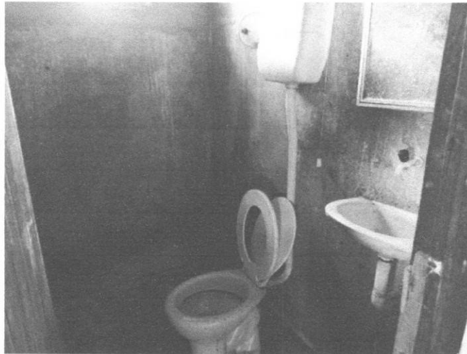
Figura 10 – Instalações hidrossanitárias: banheiro
