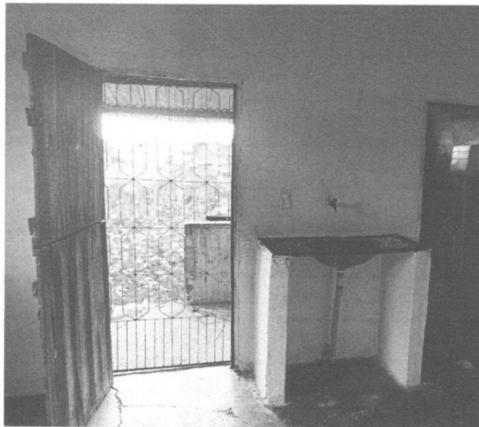
Figura 11 – Instalações hidrossanitárias: cozinha
