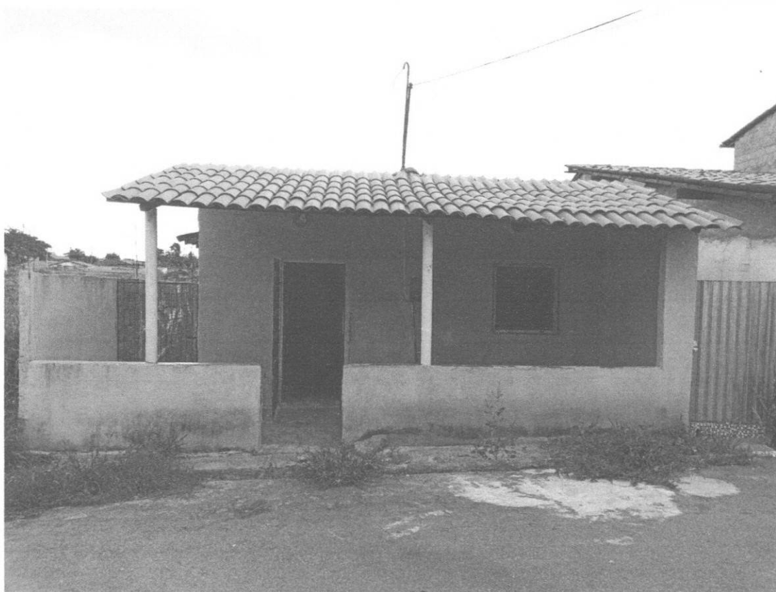
LAUDO TÉCNICO – PRÉDIO PARA ALUGUEL SOCIAL NO DISTRITO DE SUCESSO PELA PREFEITURA MUNICIPAL DE TAMBORIL-CE
