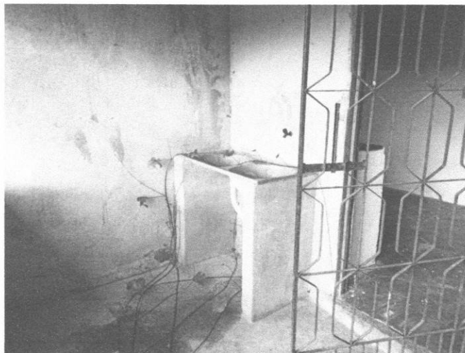
Figura 12 – Instalações hidrossanitárias: lavanderia
