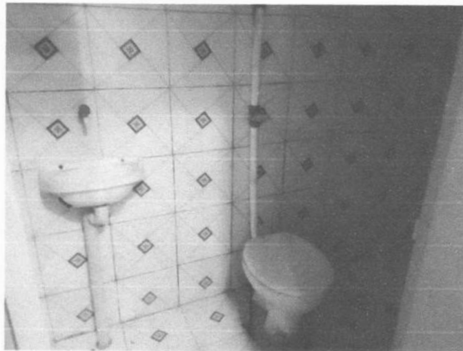
Figura 16 – Instalações hidrossanitárias banheiro
