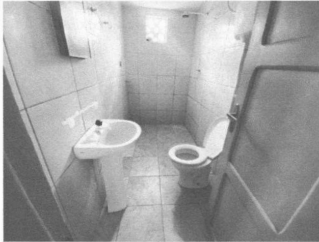
Figura 13 - Instalações hidrossanitárias banheiro
