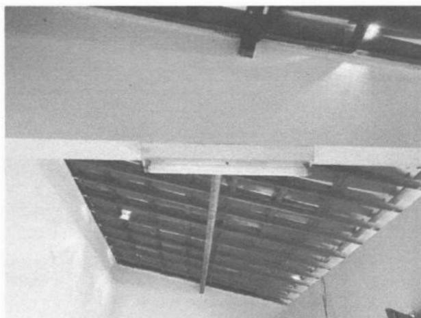
Figura 8 – Ponto de iluminação
