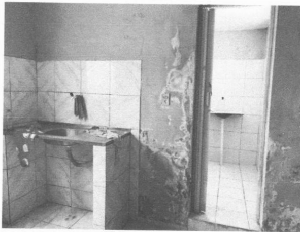
Figura 7 – Revestimento argamassado com manchas de umidade
