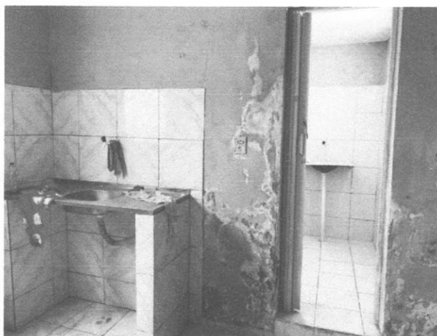
Figura 16 - Instalações hidrossanitárias da cozinha
