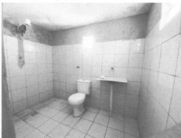
Figura 15 - Instalações hidrossanitárias do banheiro
