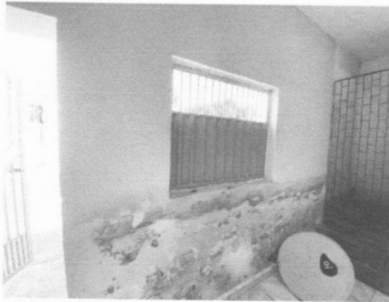
Figura 6 – Revestimento argamassado com manchas de umidade
