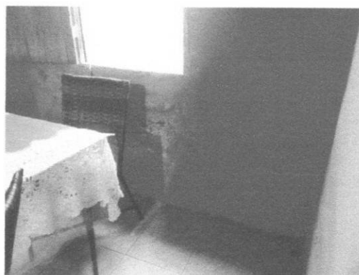
Figura 4 – Revestimento parede com manchas de umidade
