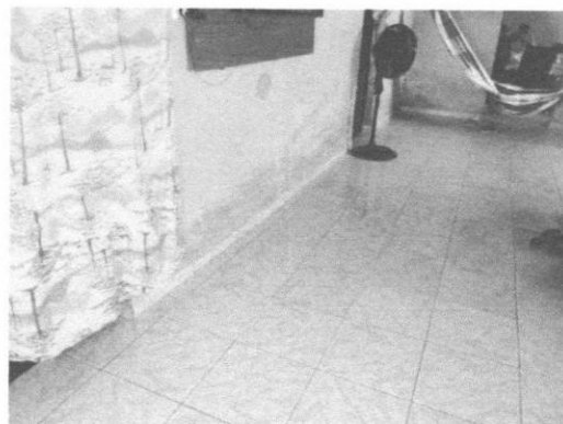
Figura 5 – Revestimento parede com mancha de umidade
