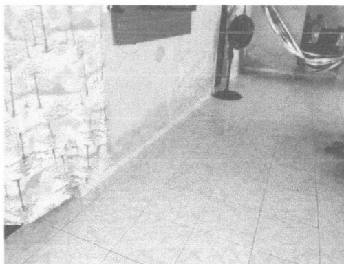
Figura 5 – Revestimento parede com mancha de umidade
