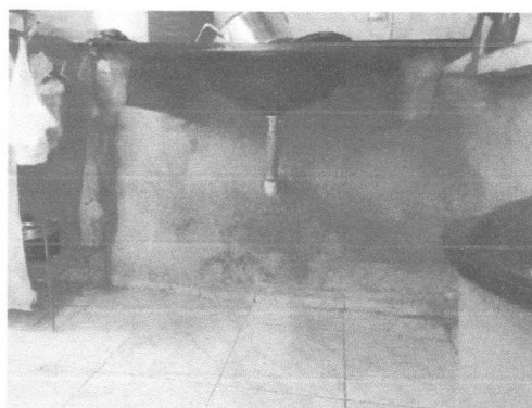
Figura 12 - Instalações hidrossanitárias cozinha
