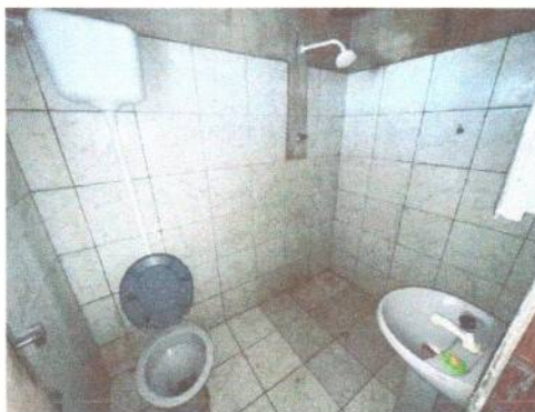
Figura 17 - Instalações hidrossanitárias banheiro
