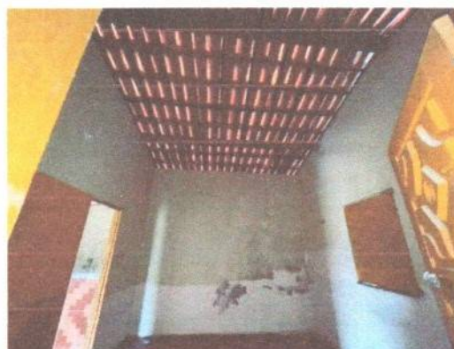
Figura 8 – Revestimento parede com manchas de umidade
