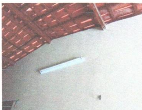
Figura 13 – Ponto de iluminação
