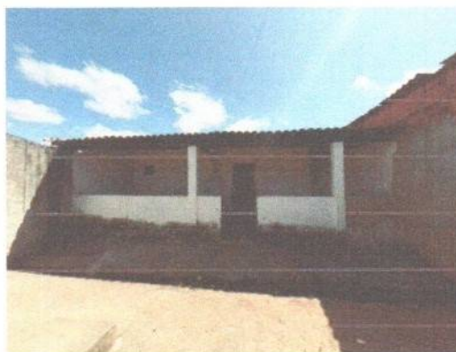
Figura 6 – Revestimento parede com mancha de umidade
