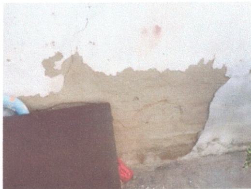
Figura 6 – Desagregação do revestimento na área externa
