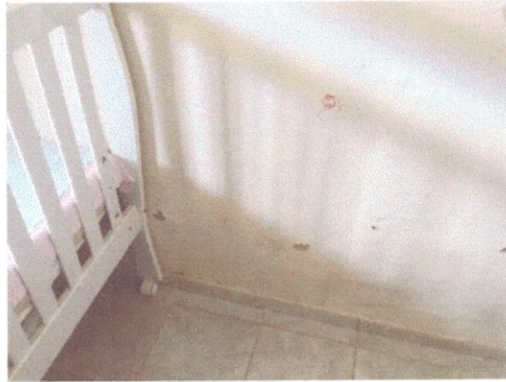
Figura 5 – Umidade advinda da fundação
