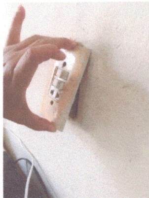
Figura 8 – caixa de luz quebrada
