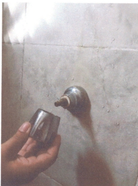
Figura 12 – Instalações hidrossanitárias: banheiro
