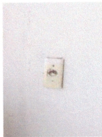
Figura 7 – tomada com patologia e marcas de incêndio causado por curto circuito
