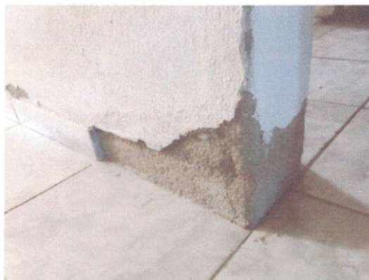
Figura 4 – Desagregação do Revestimento
