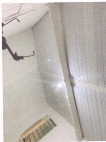
Figura 5– Ponto de iluminação no teto
