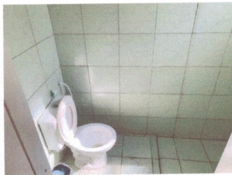
Figura 11– Instalações hidrossanitárias: banheiro
