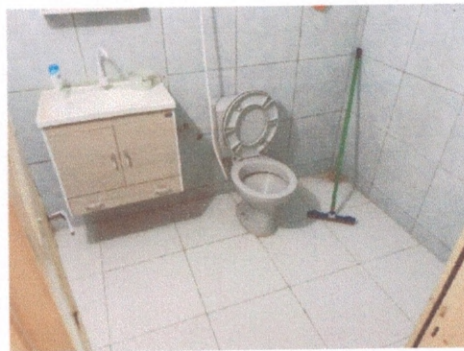
Figura 12– Instalações hidrossanitárias: banheiro
