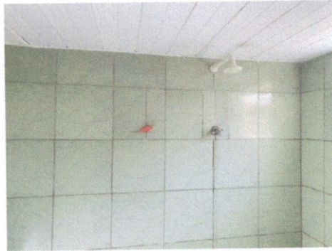
Figura 10– Instalações hidrossanitárias: banheiro
