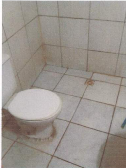
Figura 12 – Instalações hidrossanitárias Banheiro 01
