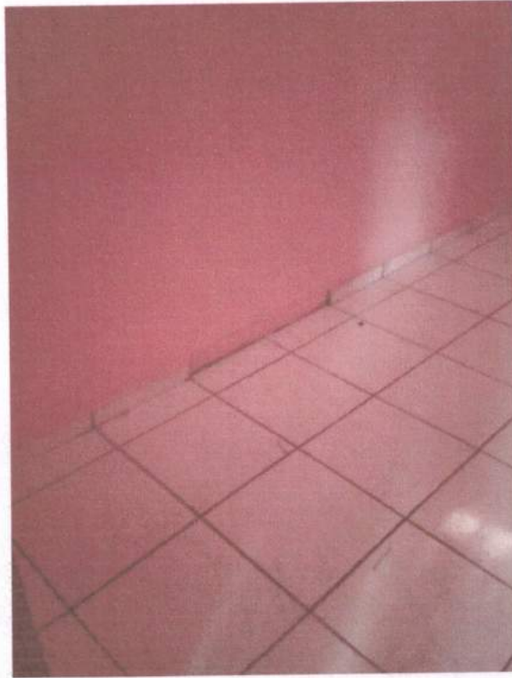
Figura 8 – cerâmica faltando rodapés
