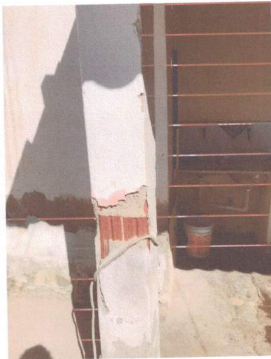
Figura 4 - Pilar em degradação
