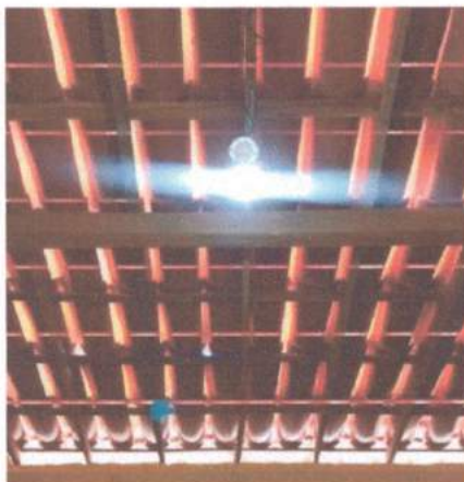
Figura 12- Lâmpada instalada em caibros e ripas
