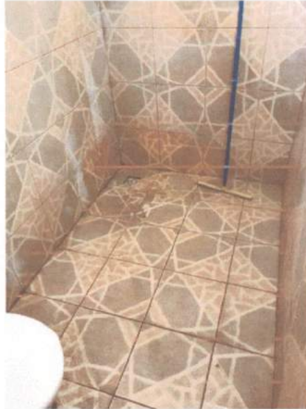
Figura 10 – piso do banheiro
