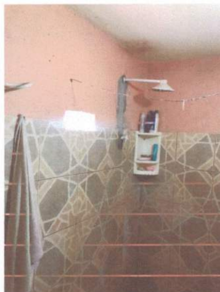
Figura 16 - Instalações hidrossanitárias banheiro
