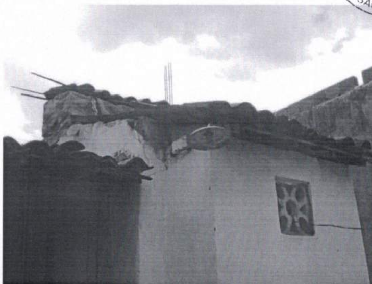
Figura 5 - Caixa d'água em deterioração
