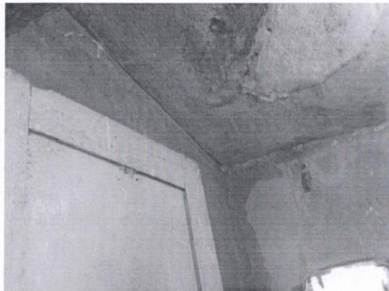
Figura 4 - Umidade na laje do banheiro
