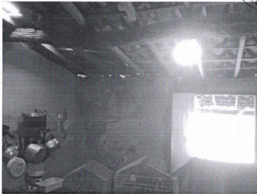
Figura 3- Mancha de umidade parede externa dos banheiros
