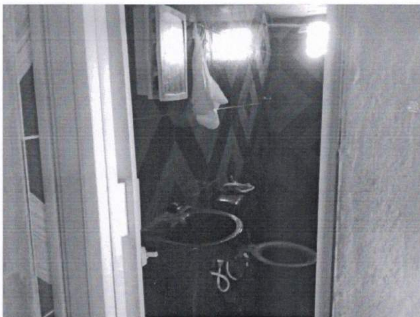
Figura 11 – Instalações hidrossanitárias banheiro
