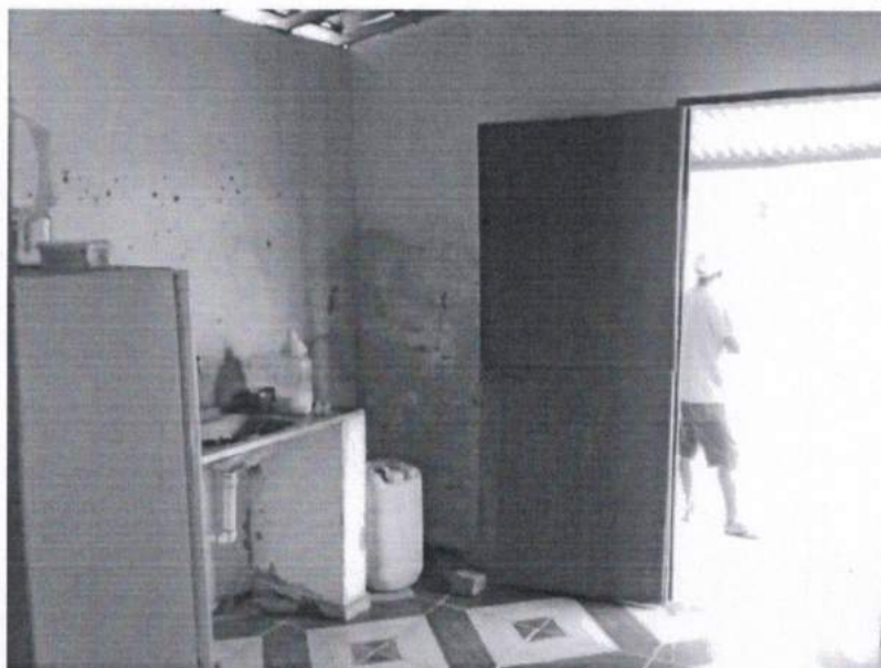
Figura 12 - Instalação hidrossanitárias cozinha
