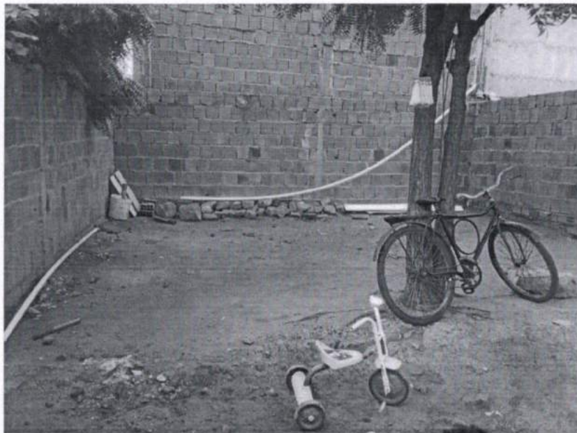
Figura 5 – Falta de reboco
