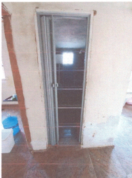
Figura 4 - Revestimento com pintura em desgaste
