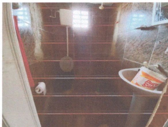
Figura 11 – Instalações hidrossanitárias banheiro
