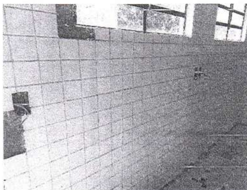
Figura 24 - Área de serviço sem interruptor e tomadas
