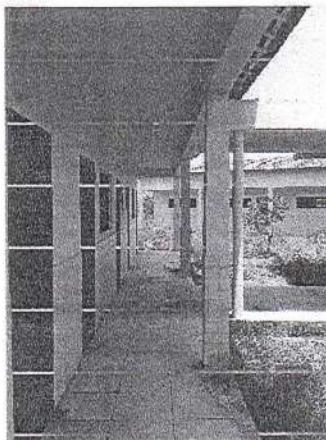
Figura 17 - Ausência de luminárias
