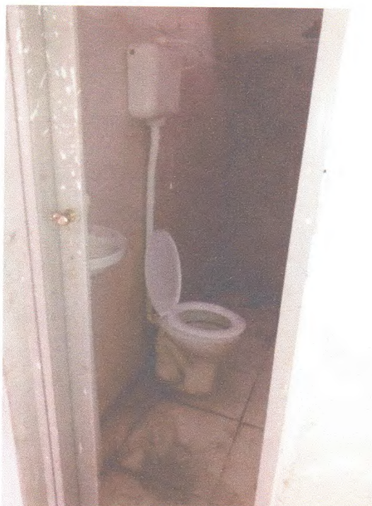
Figura 13 – Instalações hidrossanitárias: banheiro
