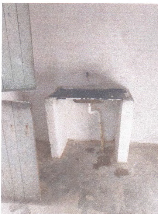
Figura 14 – Instalações hidrossanitárias: cozinha
