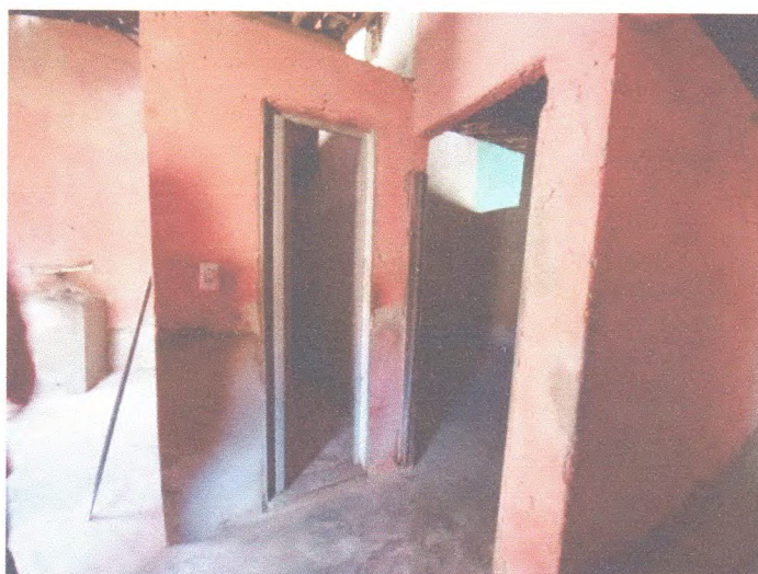
Figura 6 - Revestimento com reparos aparentes
