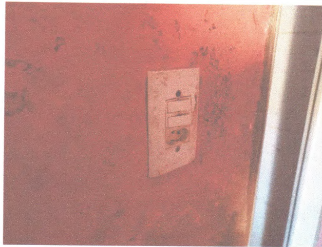
Figura 9 – Interruptor duplo e tomada
