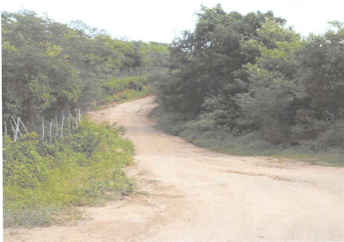
Foto 11: Estaca 102 na Inicio de Passagem Molhada Existente com seu final na Estaca 103 com 20,00 metros de comprimento por 6,00 metros de largura.
