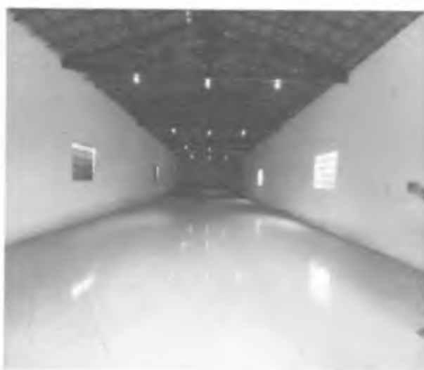
Figura 5 – Revestimento parede cômodo 1
