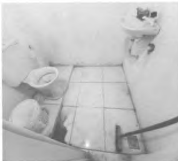
Figura 18 - Instalações hidrossanitárias banheiro
