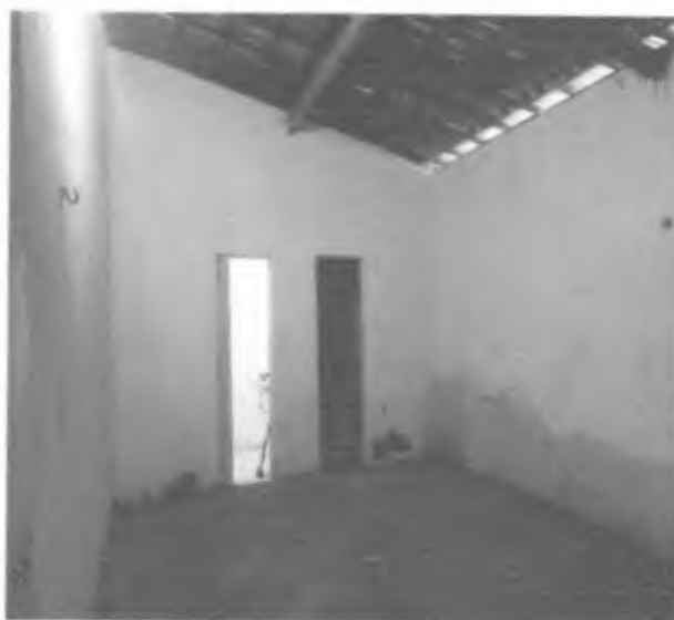
Figura 6 - Revestimento parede cômodo 2
