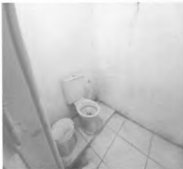
Figura 17 – Instalações hidrossanitárias banheiro
