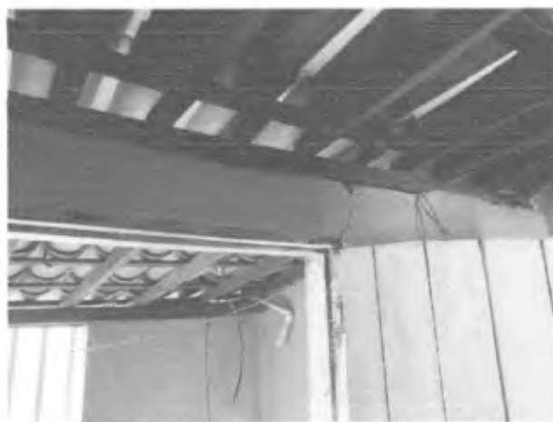
Figura 3 – Fissura em alvenaria
