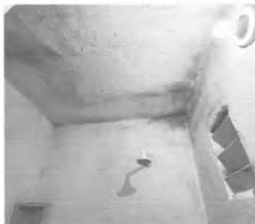
Figura 4 – Paredes e teto com manchas de umidade
