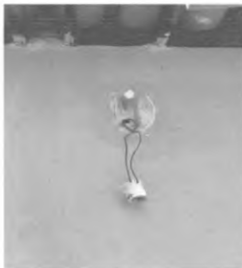
Figura 13 – Ponto iluminação com luminária quebrada
