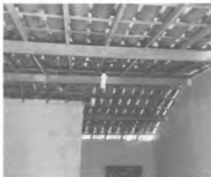
Figura 12 – Ponto de iluminação sustentado na estrutura de cobertura
