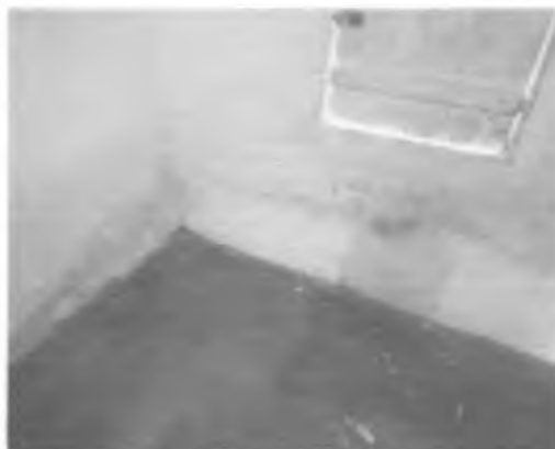
Figura 5 – Umidade advinda da fundação
