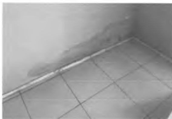
Figura 7 – Parede com pintura manchada
