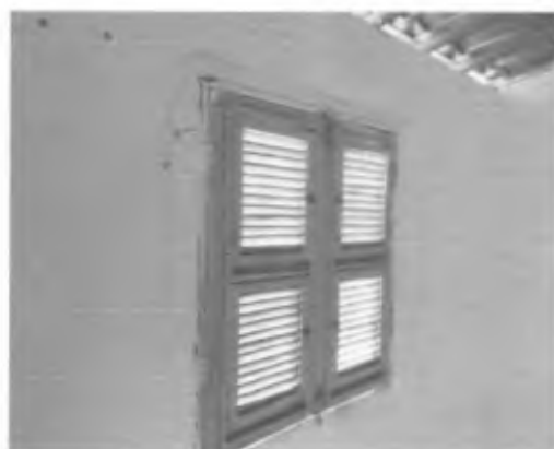
Figura 6 – Fissuras e elevação do revestimento
