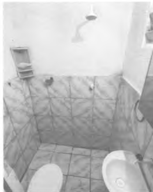
Figura 17 – Instalações hidrossanitárias: banheiro
