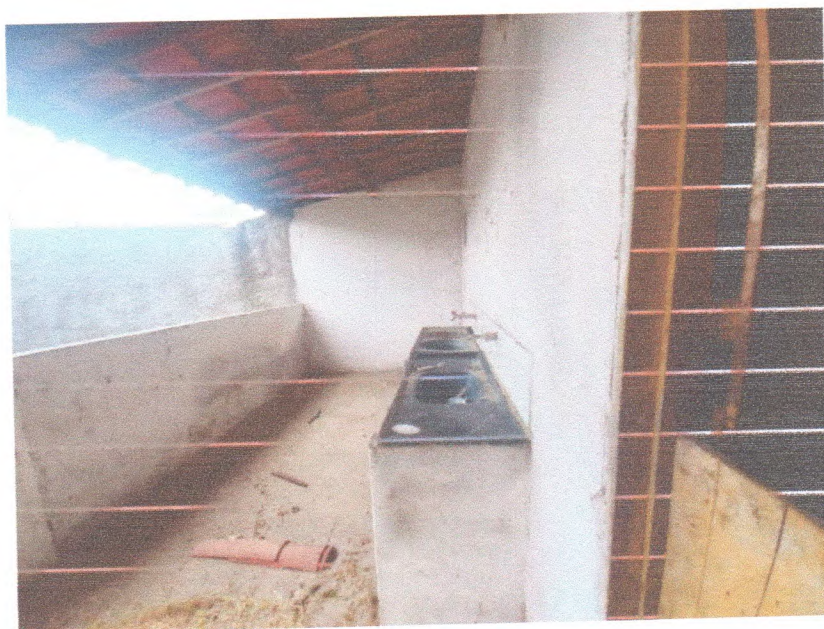
Figura 15 – Instalações hidrossanitárias: área de serviço
